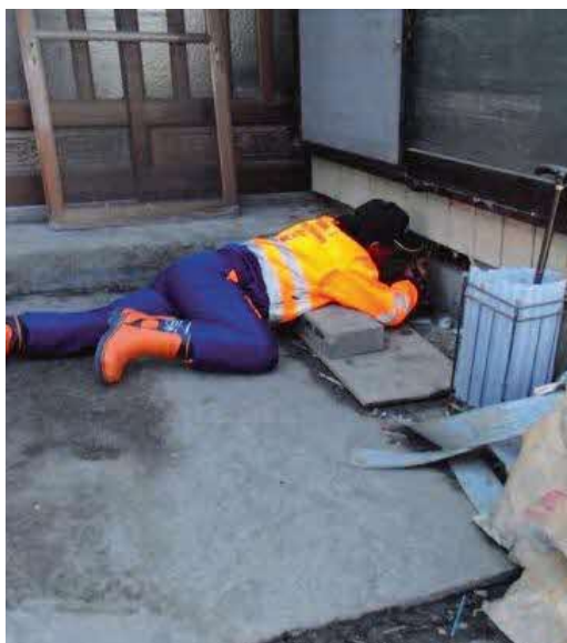
通風口から床下の泥を確認する
