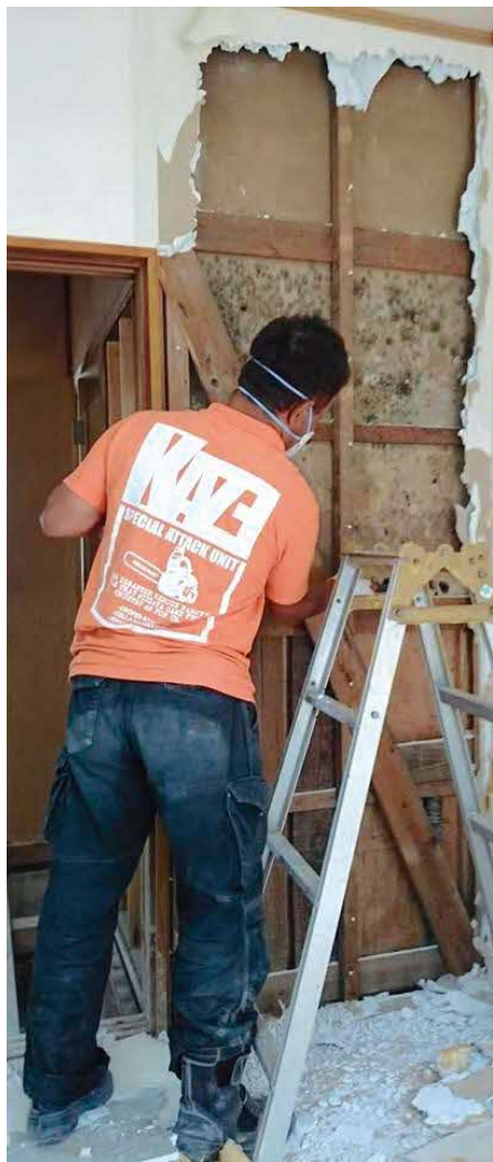
壁をはがすとカビが生えている
