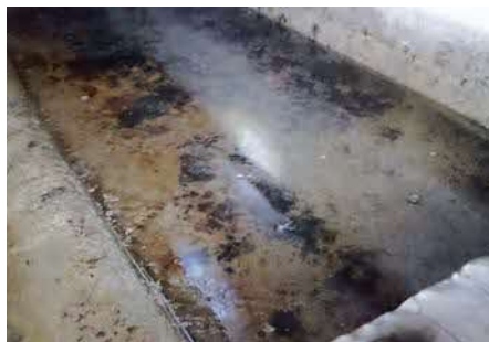
水が残って悪臭が発生する
