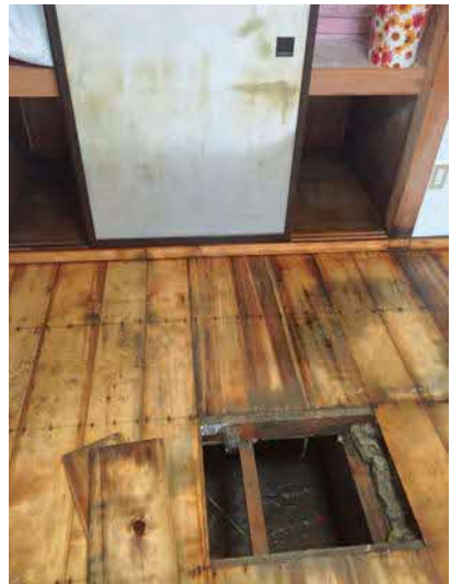
室内の被害状況も撮っておく
