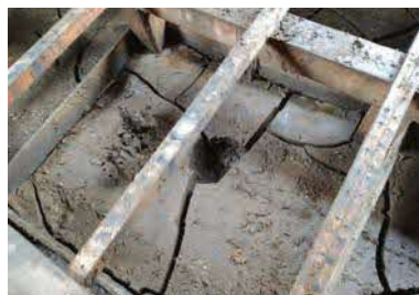
床下にたまった泥 (写真③)
