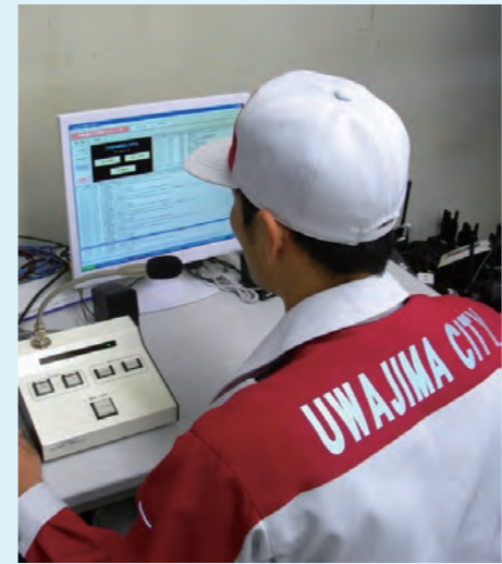
統制卓 (FM告知放送システム主制御装置) 屋外拡声子局や防災ラジオへの告知放送の他、FM告知放送システム全体の制御を担っています。
