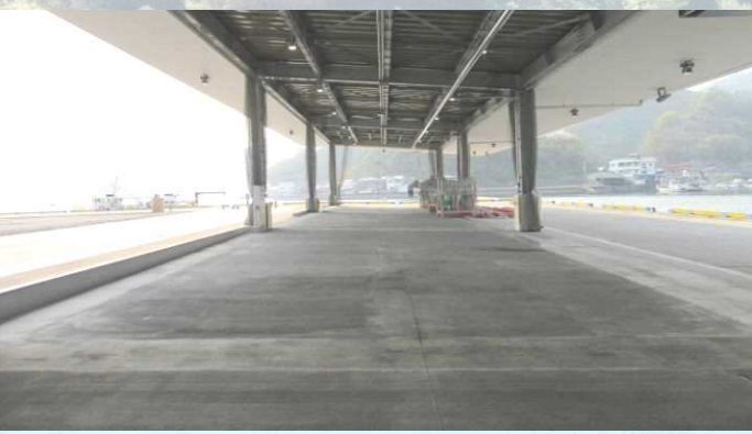
荷さばき室1 水揚げされた水産物をそのまま大型トラックに積み込める
