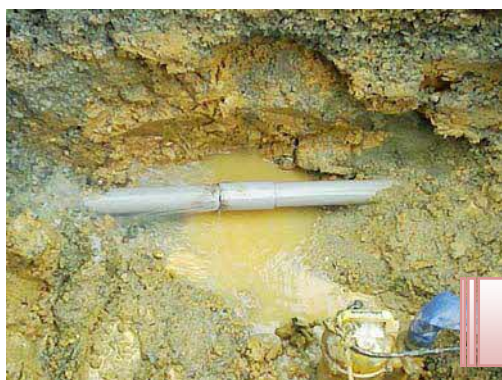
▲ 継ぎ手部の漏水
