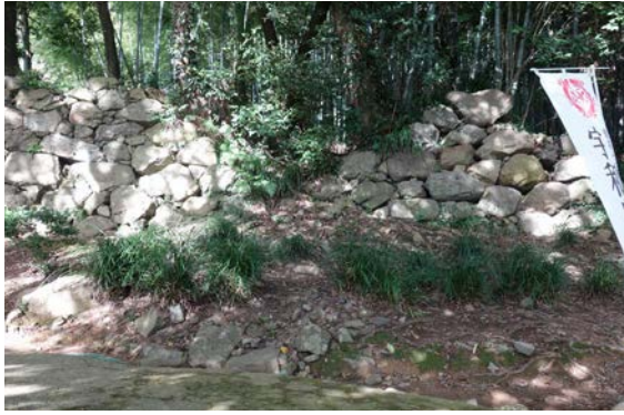
崩落した石垣
