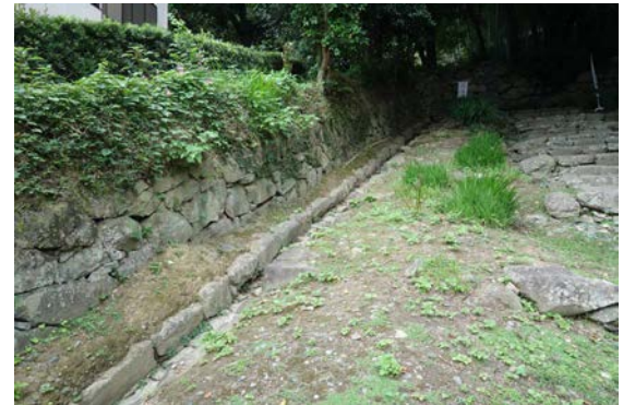
旧来の排水溝
