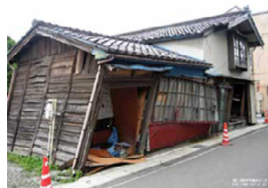
建物全体が著しく傾斜
