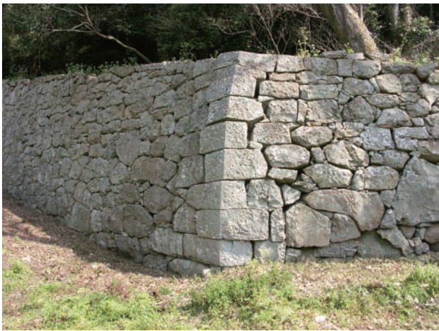
1. 崩落前の状況
