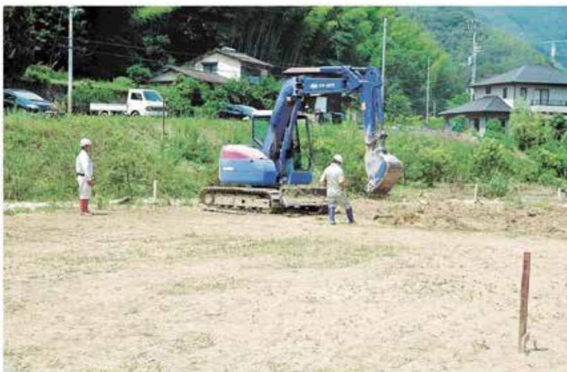
代替浄水施設の予定地を整備する作業員。19日午後1時40分ごろ、宇和島市吉田町立間
