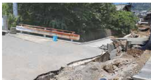
道路・橋の崩壊
