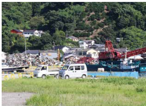
大浦に災害廃棄物処理仮置場を設置。破砕や選別を行い、可能な限り再資源化を行った
