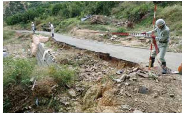
公共土木施設の災害調査の様子
