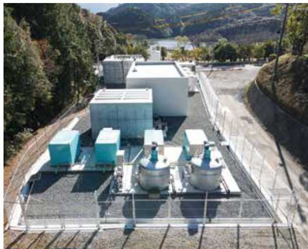
三間仮設浄水場（令和2年9月1日給水開始、令和3年3月12日整備完了） （南予水道企業団提供）
