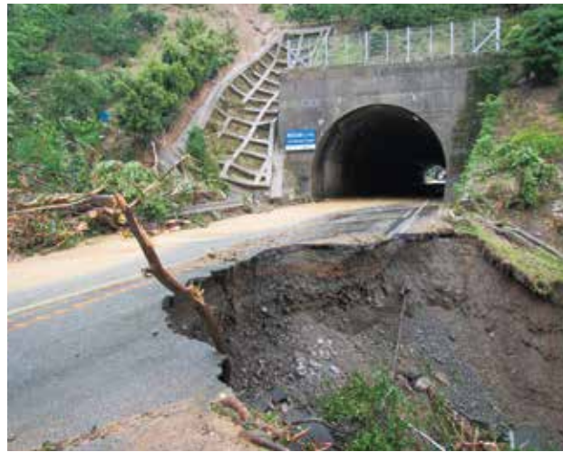
路肩がえぐれ、片側車線が完全に崩落した国道56号線 (国土交通省 四国地方整備局提供) 国道56号(法華津峠)
