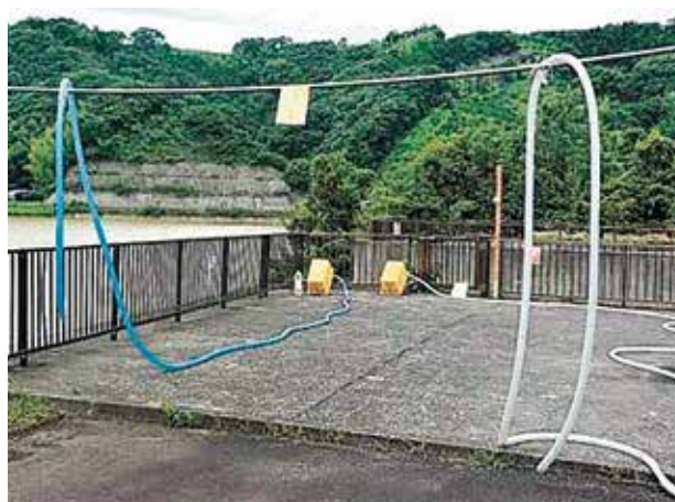
東蓮寺ダムには取水ポンプが設置された（愛媛新聞：平成30年7月13日）
