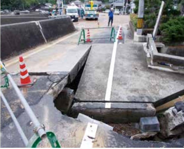
背面の洗掘により落橋した門田橋
