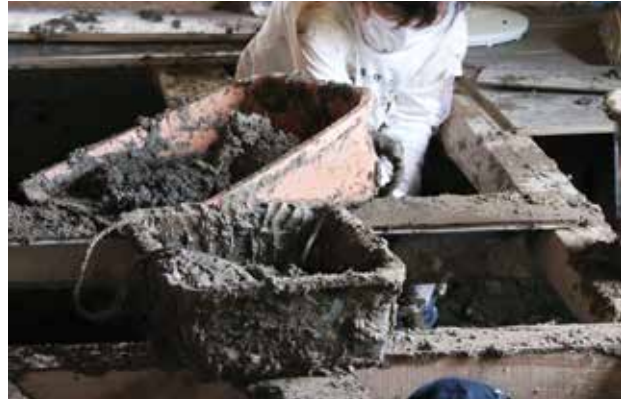
住宅には多くの土砂が流れ込んだ 吉田町立間 P21 E-4
