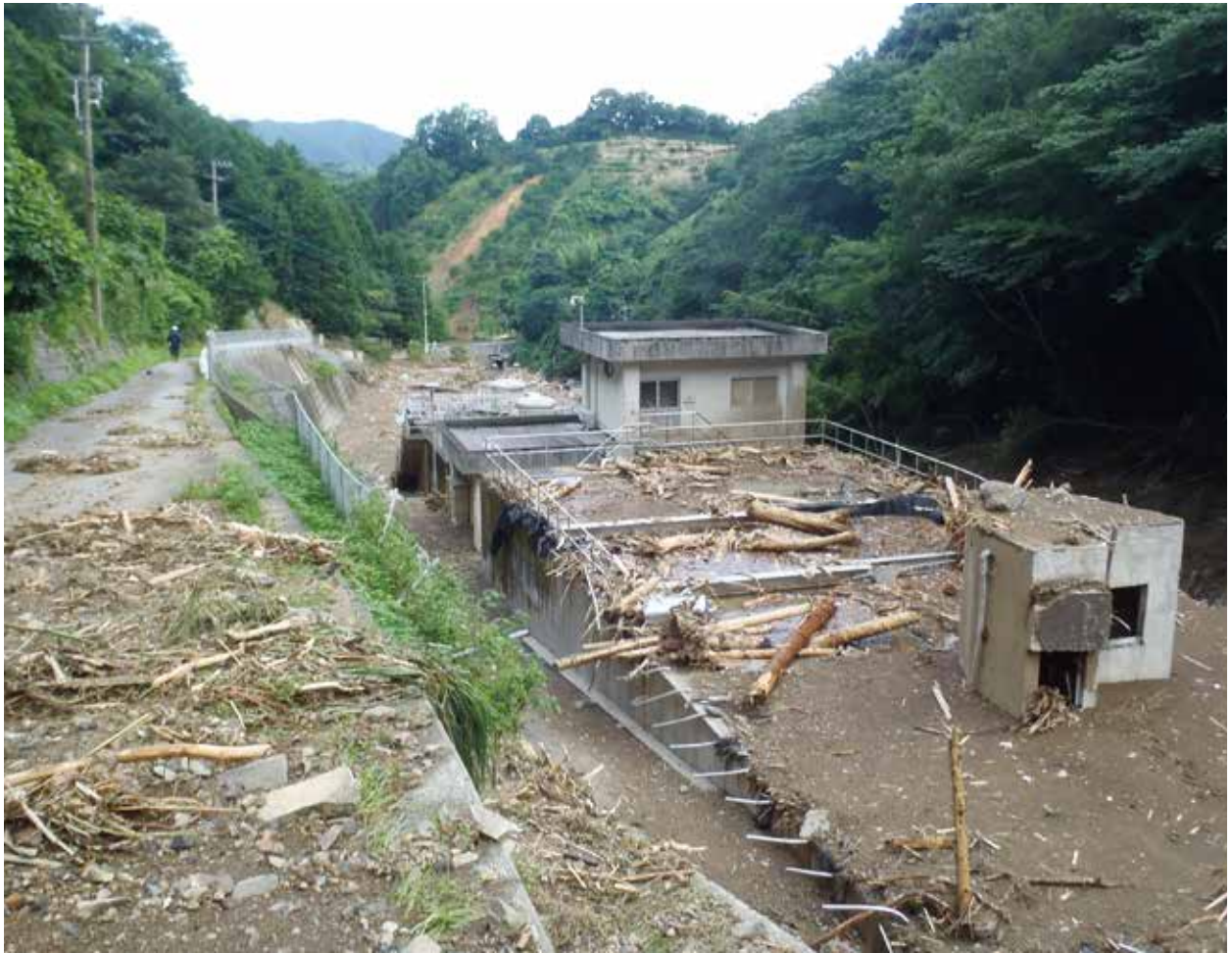
土砂災害で被災した吉田浄水場（沈でん池）
