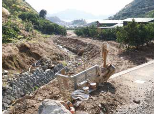
園地での作業に必須のモノレールや、灌水作業に必要なスプリンクラーも大きな被害を受けた
