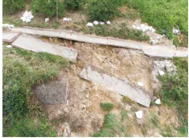
園地に向かう農道も土砂崩れや崩落で通行ができなくなり、 園地の被災状況の確認にも時間を要した
