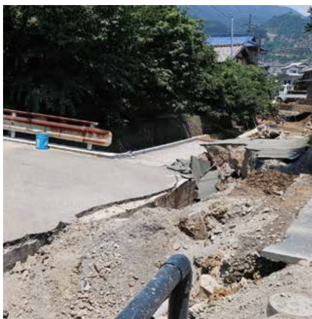
土石流により崩壊した道・橋 (中島橋)
