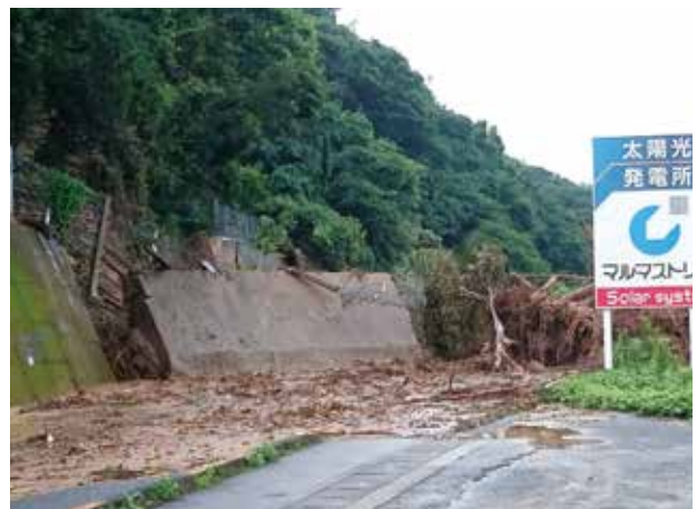
土石崩れにより、国道56号線の通行止め・片側通行が長期間続いた（市民提供）
