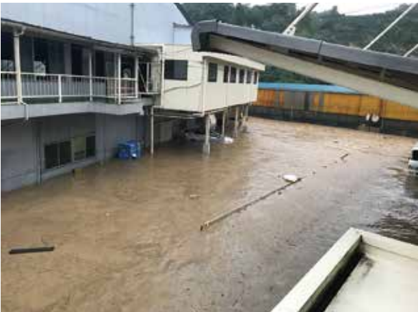
店舗浸水の被害にあった柑橋加工施設 (愛工房様提供)
