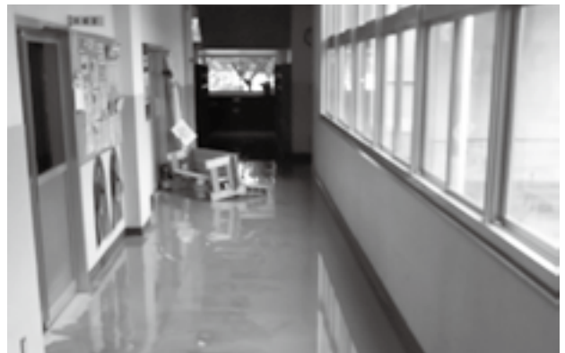
校舎のほか、体育館やプールなど全ての建物が被災
