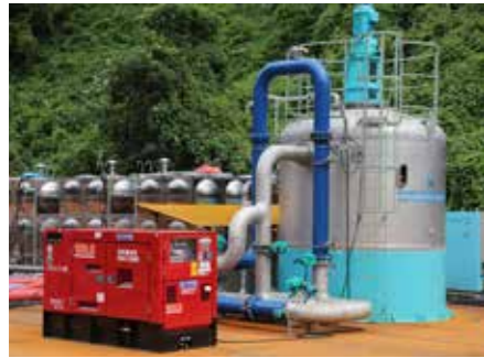
▲代替仮設浄水施設
