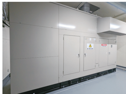
非常用発電設備
