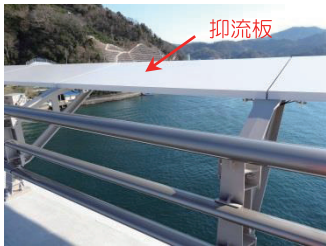
抑流板付防護柵
