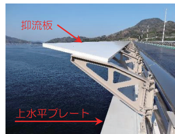
抑流板付防護柵
